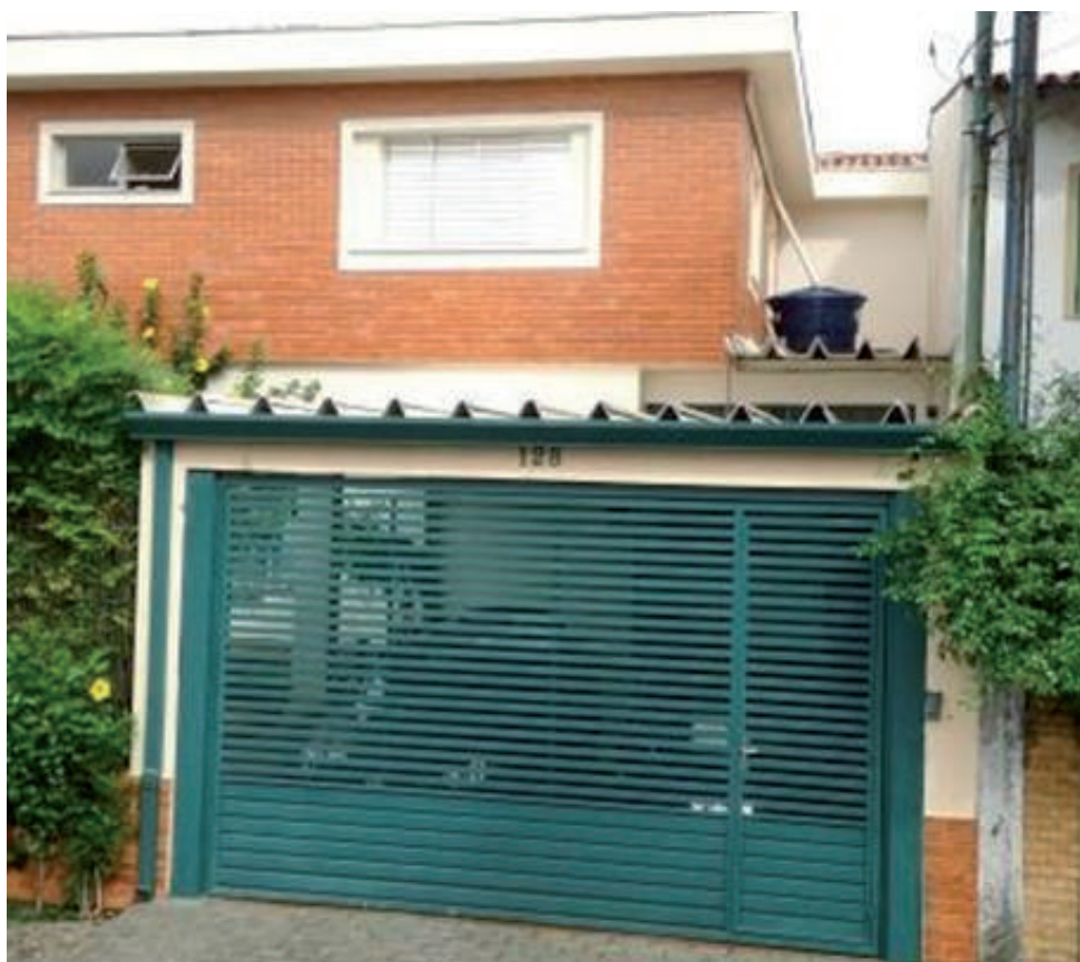
Figura 12 - Dispositivo para acumulação e uso de águas de chuva através de recolhimento das águas pluviais incidentes sobre o telhado.
