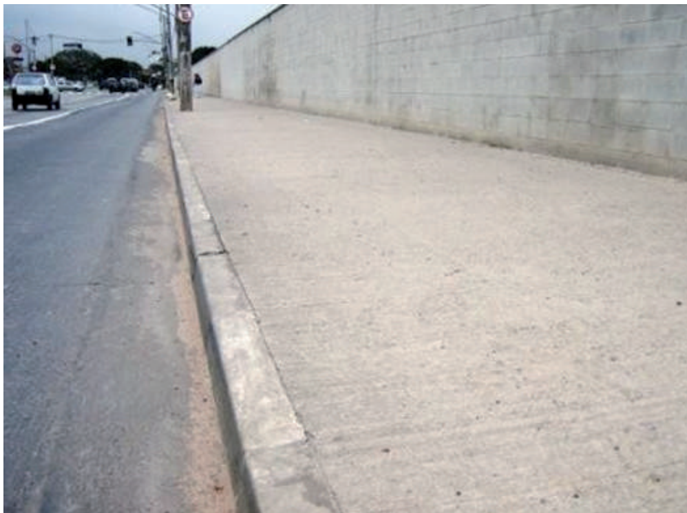
Figura 15 - Exemplo com sarjeta e calçada totalmente impermeáveis.
